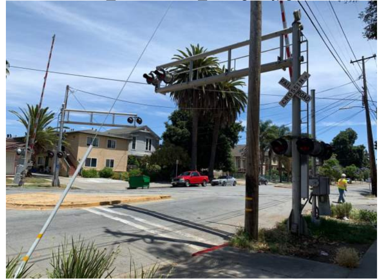
22_N 5 St Gate_facing W.jpg
